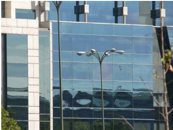
Fig. 4.8. Aspecto de un acristamiento sometido a los efectos de las presiones "isócoras" en su cámara.
